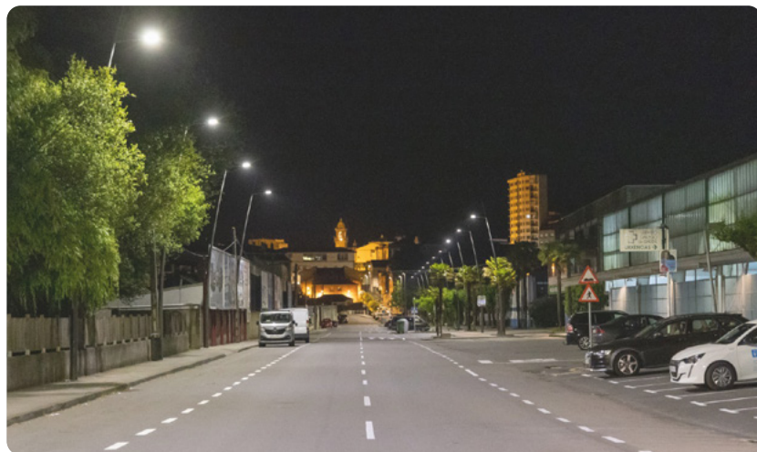
Na zona urbana instaláronse luminarias en todas as rúas
